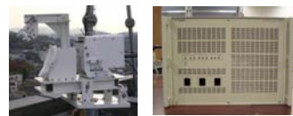
基地局 Base station
